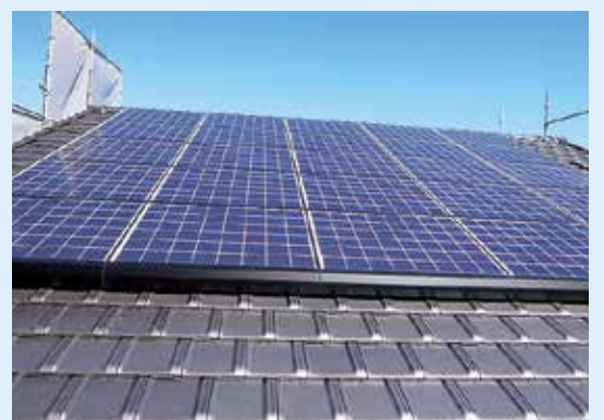
太陽光発電+ハイブリッド給湯機を設置
