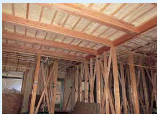
省エネルギー対策等級4 さらに断熱・防音対策で1階天井部にもウレタン断熱を吹き付け
